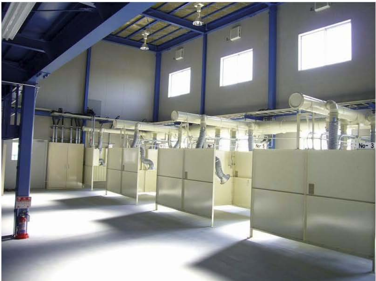
システムアップされた溶接実習場
