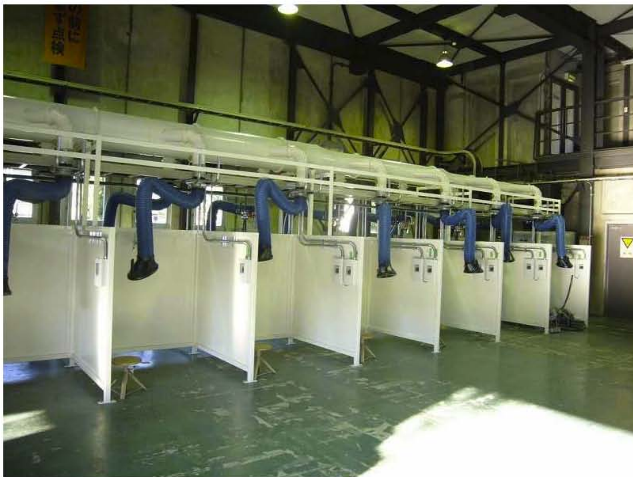
電気配線、ガス配管、照明等、一体化された実習場
